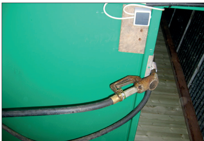
Placée à l'intérieur, la cuve de carburant offre plus de sécurité contre les vols. La conservation du gasoil n'en sera que meilleure.
